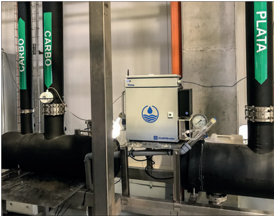
Der ColiMinder bei Romaqua – installiert am Rohwasserzulauf des stillen und des natürlich karbonisierten Mineralwassers.
